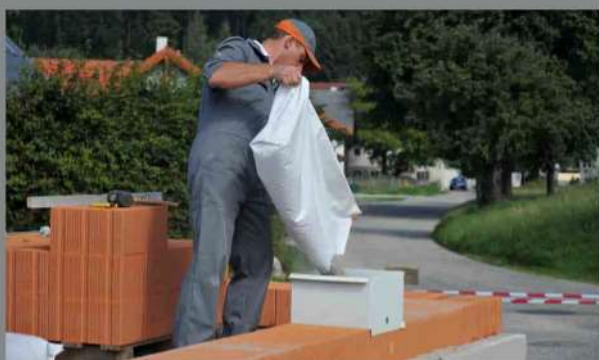
Vollständig verfüllter Hohlziegel
